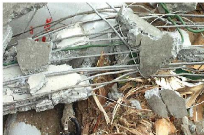
流出後、埋没した容器
